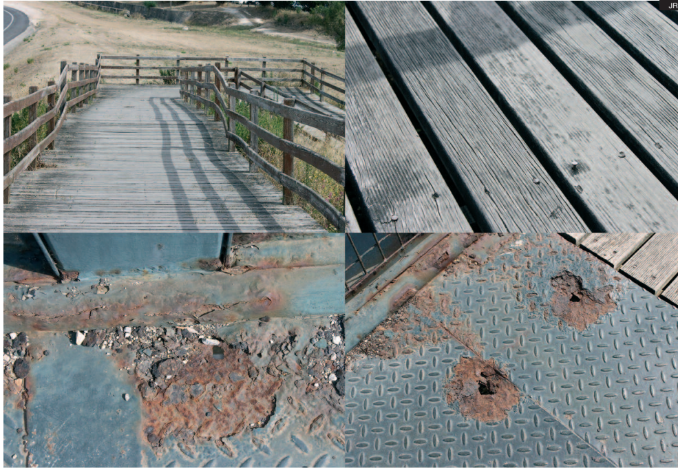
Viaduto pedonal da Avenida Poente apresenta evidentes sinais de degradação
